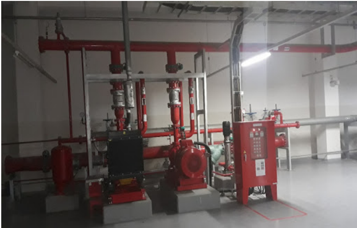
Dự án: Cung cấp và lắp đặt hệ thống phòng cháy chữa cháy - giai đoạn 1 thuộc công trình Dịch vụ kho bãi nhà xưởng cho thuê - Mỹ Hòa- Hưng Yên.
