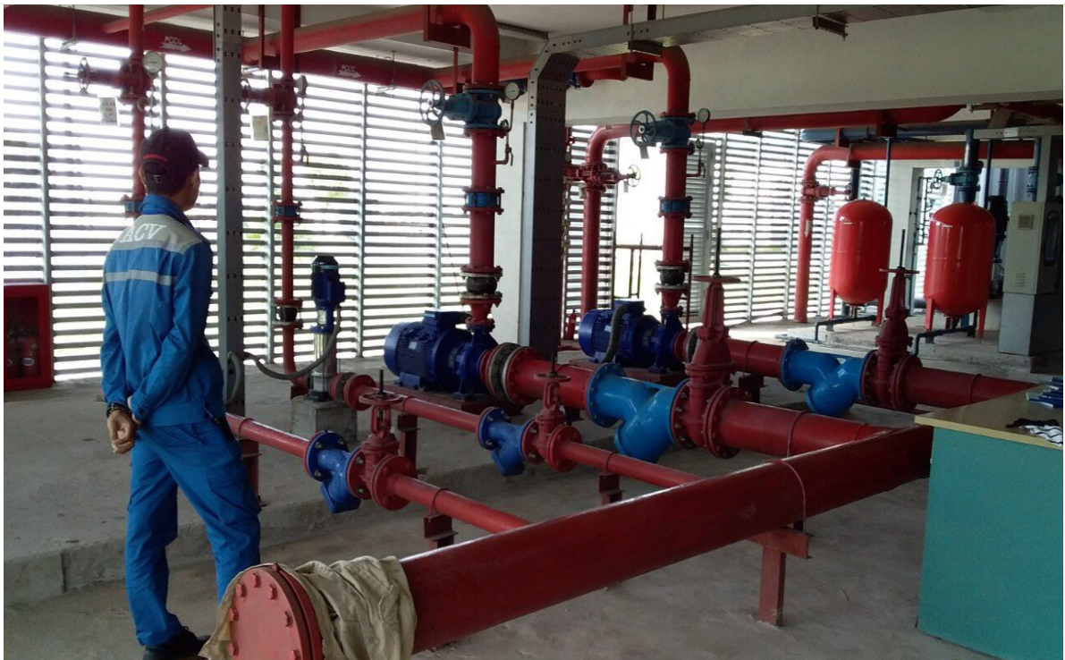
Dự án: Thi công hệ thống chữa cháy FM200 thuộc công trình Nhà máy nhiệt điện Hải Phòng 1,2- Thủy Nguyên – TP. Hải Phòng.
